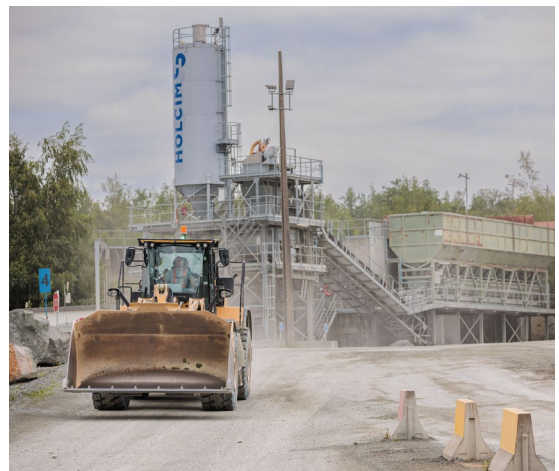
Ternaire installatie in de groeve van Ermitage
