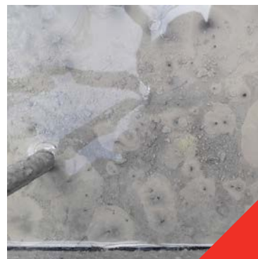
Fig 4.1.3 Ressuage dalle béton
