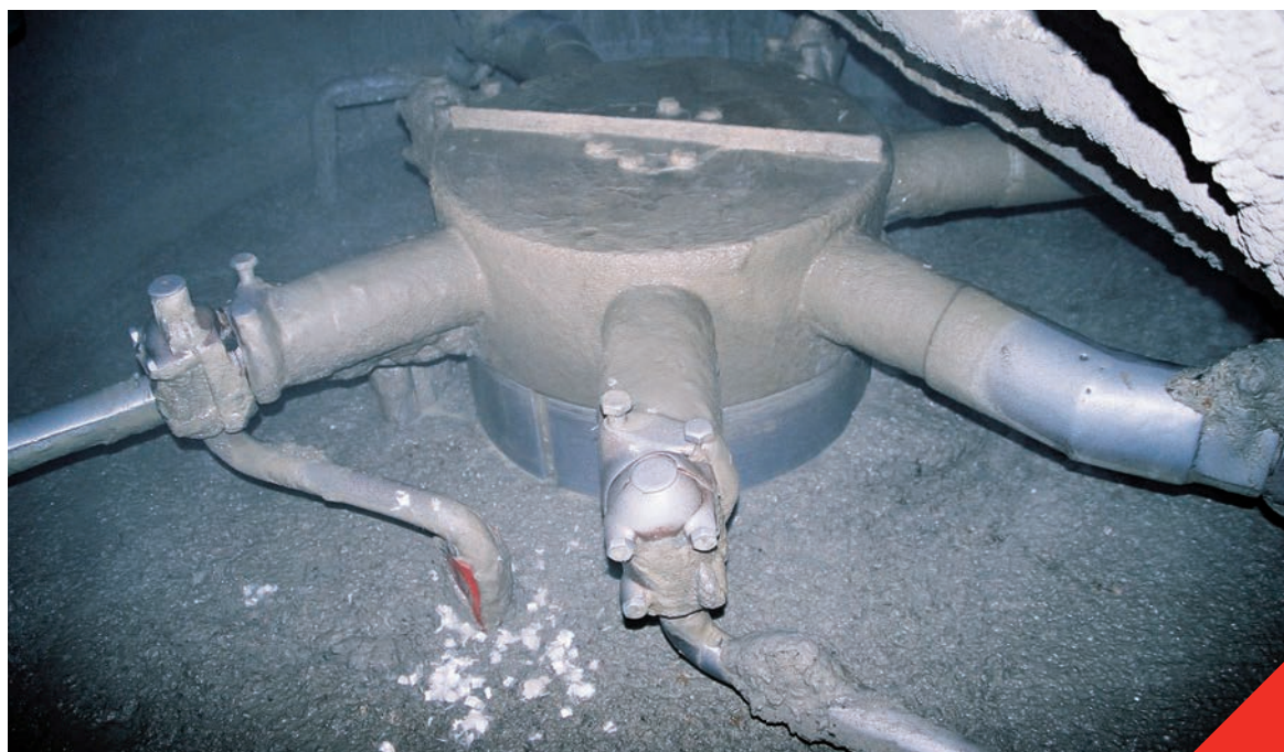
Fig 2.4.1 Vue intérieure d'un malaxeur de centrale à béton
