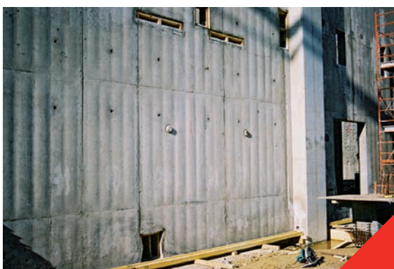
Fig 2.5.3 Manque de rigidité du coffrage et des réservations lors du coulage d'un béton fluide
