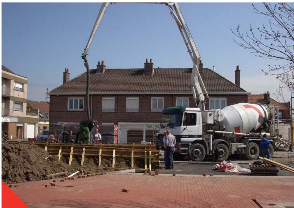
Fig 2.6.2 L'utilisation du mixopompe permet de réduire l'encombrement en ville
