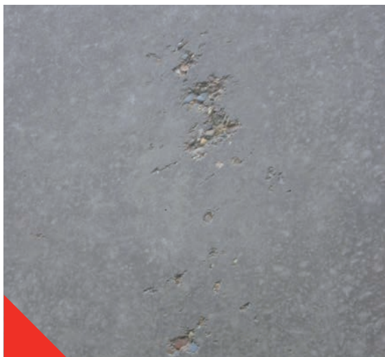
Fig 2.5.6 Absence de produits de démoulage à certains endroits ayant entraîné l'arrachement du béton lors du décoffrage
