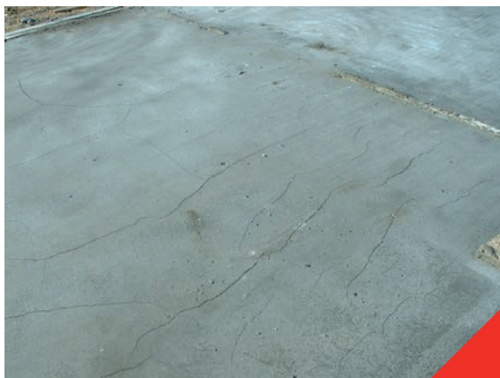
Fig 4.2.6 Fissures de retrait plastique, dues à l'absence ou la mise en œuvre trop tardive de cure
