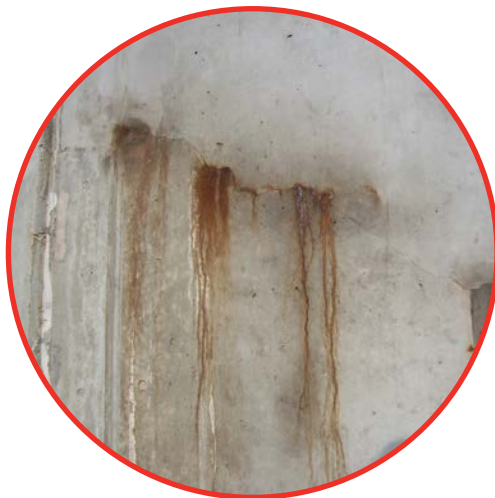
Fig 4-3-1 Signes de corrosion visibles en surface du béton : traces de rouille (photo à gauche), décollements du béton au-dessus d'une armature corrodée (photo à droite)
