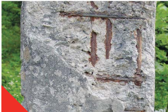
Fig 4.3.5 Dégâts de corrosion d'une armature : érosion par corrosion régulière de la barre d'armature sous l'effet de la carbonatation
