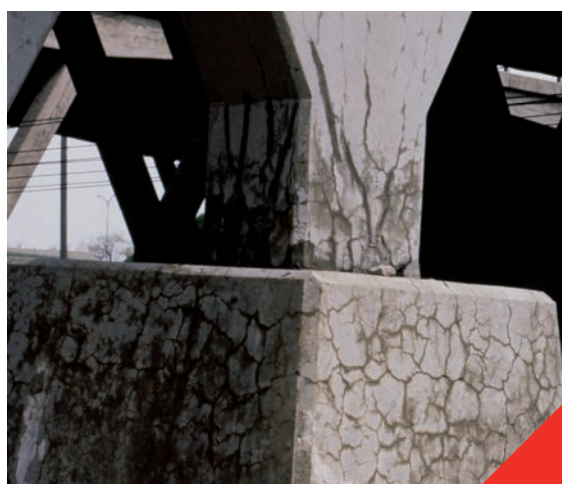
Fig 4.9.2 Ouvrage atteint de réaction alcali-silice
