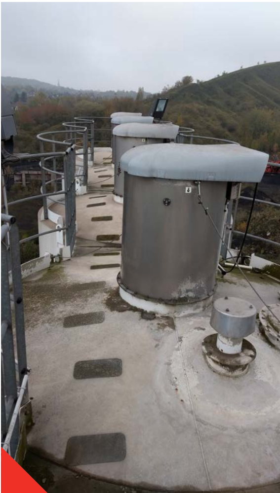
Fig 5.2.2 Filtres au sommet des silos d'une centrale à béton
