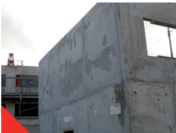
Fig 2.5.7 Différences de teinte d'un parement en béton dues à une mauvaise répartition de l'agent de démoulage
