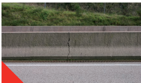
Fig 4.2.8 L'absence de joints dans les glissières de sécurité provoque des fissures régulières dues au retrait de dessiccation
