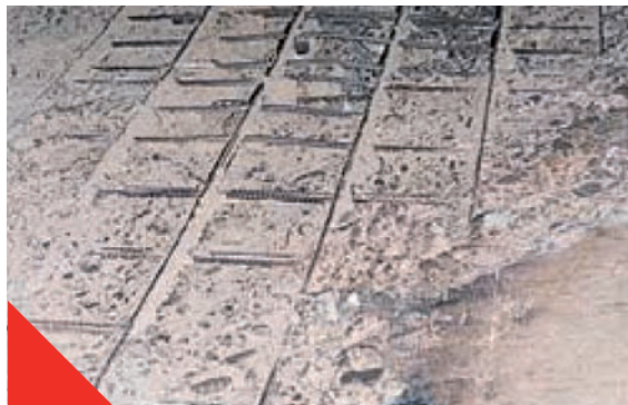
Fig 4.10.1 Armatures mises à nu suite à l'éclatement du béton d'enrobage lors d'un incendie
