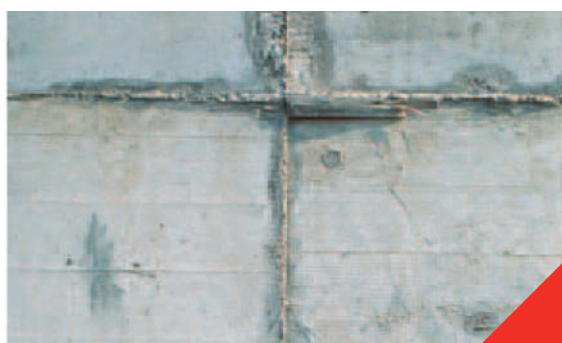
Fig 2.5.2 Effet d'une étanchéité insuffisante des joints de coffrage
