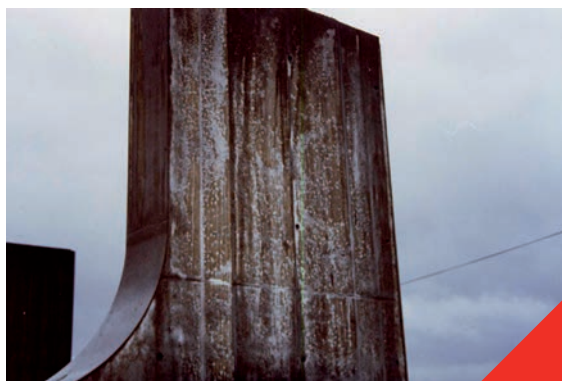
Fig 4.4.2 Efflorescences sur un mur en béton soumis à la pluie après décoffrage
