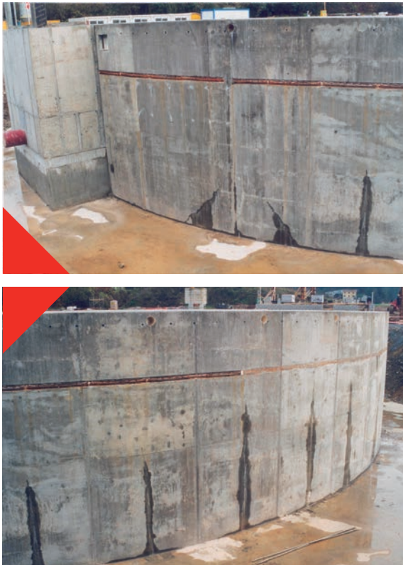
Fig 4.2.2 Scheuren in een (verondersteld) waterdichte constructie
