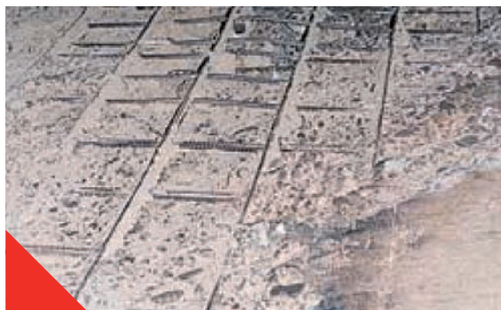
Fig 4.10.1 Blootgestelde wapening door het afspatten van de betondekking bij een brand
