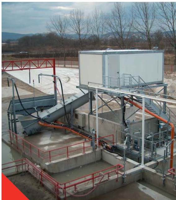
Fig 1.2.1 Installatie voor de behandeling van spelwater in een betoncentrale: scheidingstoestel, bezinkbekkens en gebouw met filterpers
