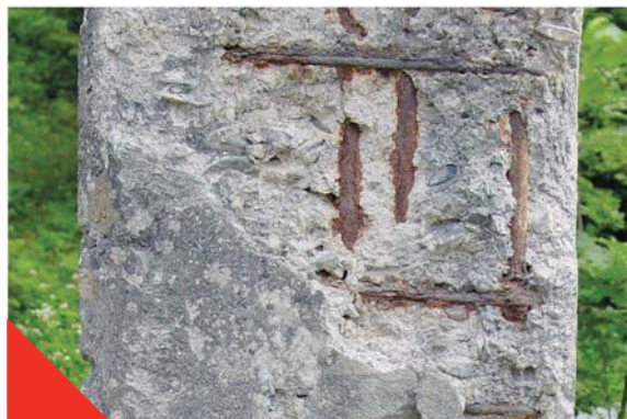
Fig 4.3.5 Schade door gelijkmatige wapenings- corrosie als gevolg van carbonatatie
