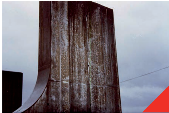
Fig 4.4.2 Uitbloeiingen op een betonnen muur die na ontkisting blootgesteld werd aan regen
