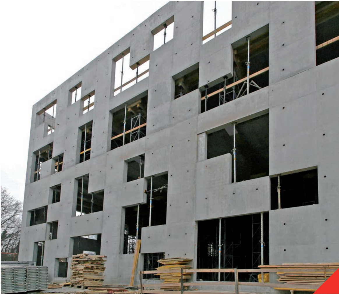
Fig 3.2.10 Dankzij ZVB kon de realisatie van deze complexe vormen uitgevoerd worden met een minimum aan betonneerfasen
