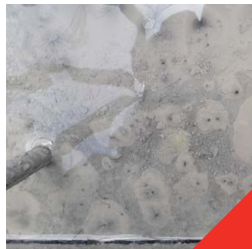
Fig 4.1.3 Bleeding van een betonvloer
