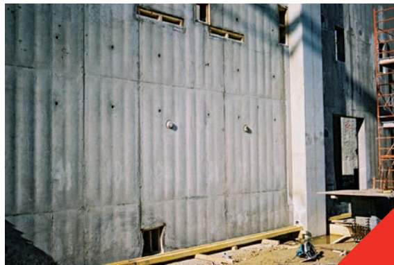
Fig 2.5.3 Onvoldoende stijfheid van de bekisting en van de uitsparingen tijdens het storten van vloeibaar beton
