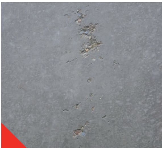
Fig 2.5.6 Door een lokaal tekort aan ontkistingsproduct is het beton bij het ontkisten plaatselijk afgerukt
