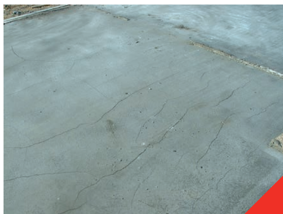
Fig 4.2.6 Plastische krimpscheuren in een vloer, te wijten aan het niet of te laat nabehandelen
