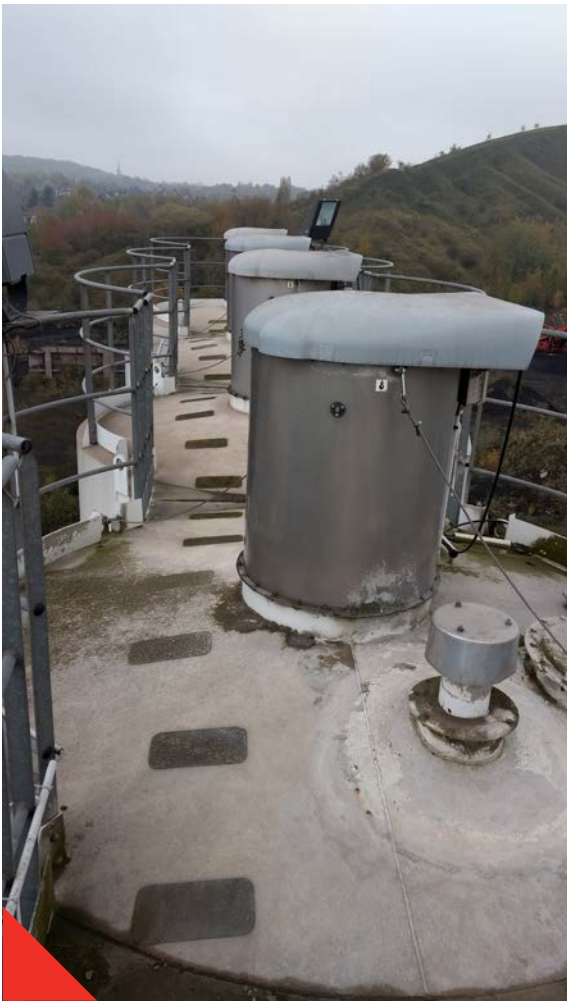
Fig 5.2.2 Filters bovenop de silo's van een betoncentrale
